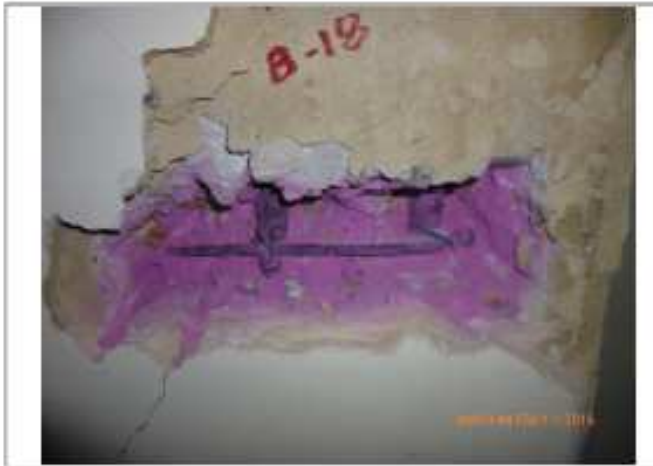
Foto 3: Exploración Columna para visualizar refuerzo, carbonatación, recubrimiento
