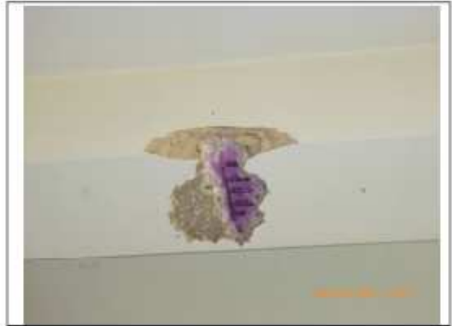
Foto 2: Regata para determinar refuerzo inferior en vigas que conforman la placa del segundo piso, y carbonatación de la misma.
